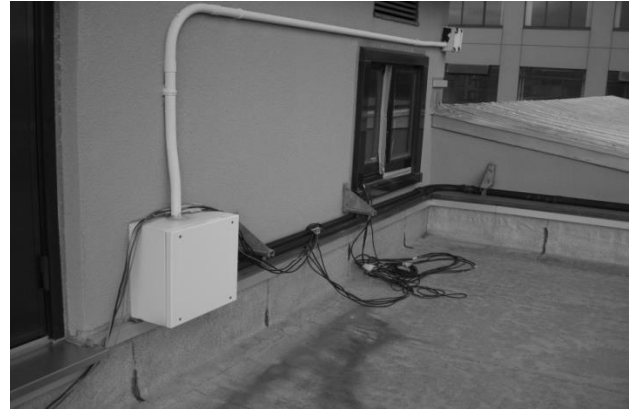
図11 配線の取り回し
