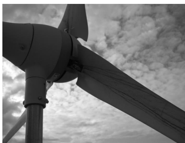
図 22 ブレード取り付け部の汚れ
