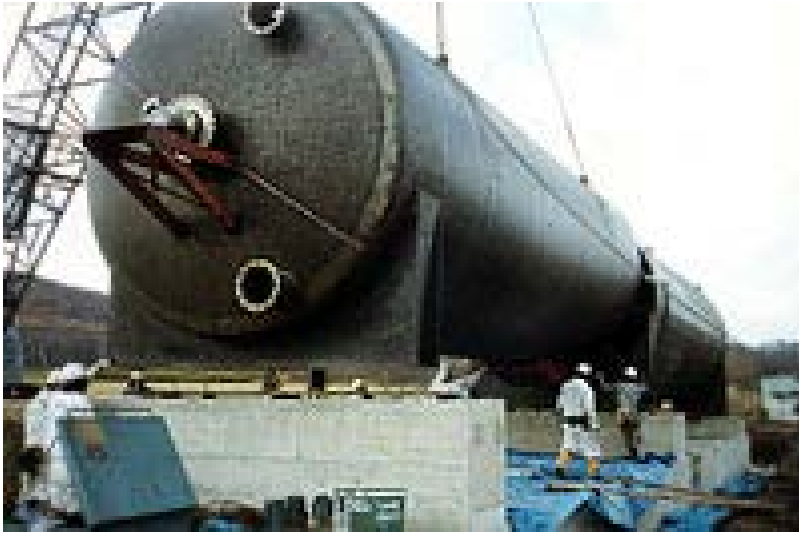
図 6-9 バイオガス設備機械一式（メタンガス発酵槽据付）
