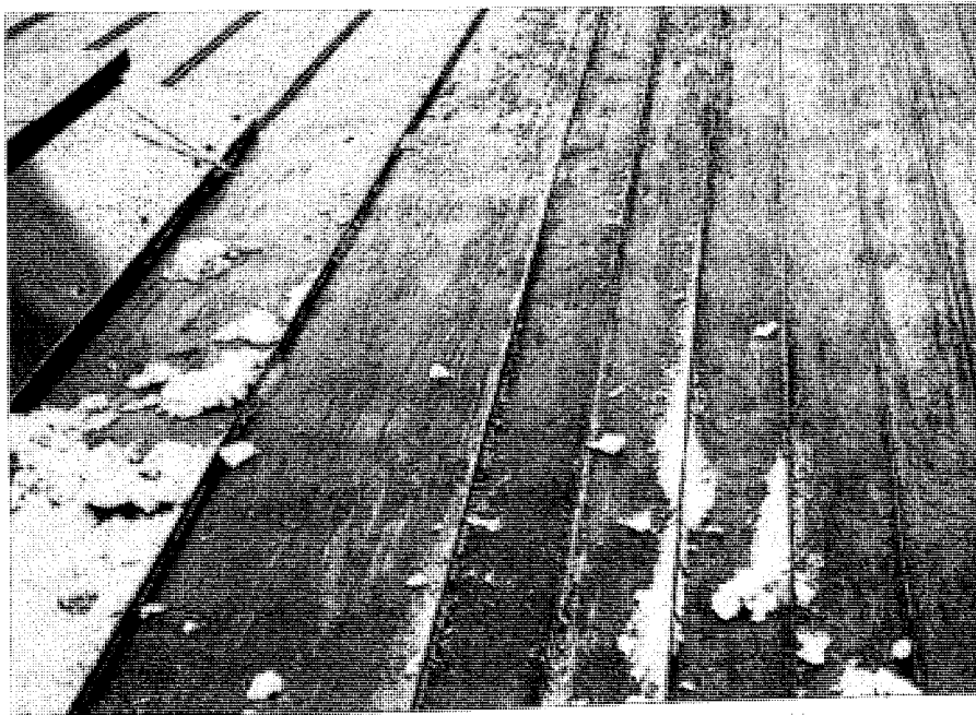
写真 3 - 6 滑雪後の屋根表面の状態
