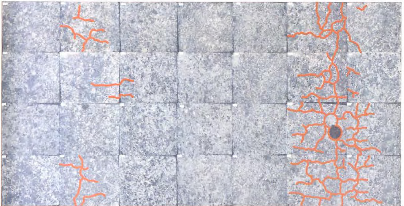
写真-4.10 T1-2 断面のひび割れ（底面側）
