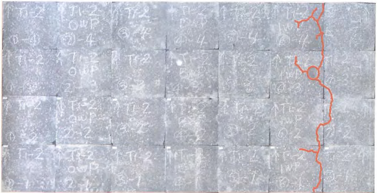
写真-4.9 T1-2 断面のひび割れ（表面側）
