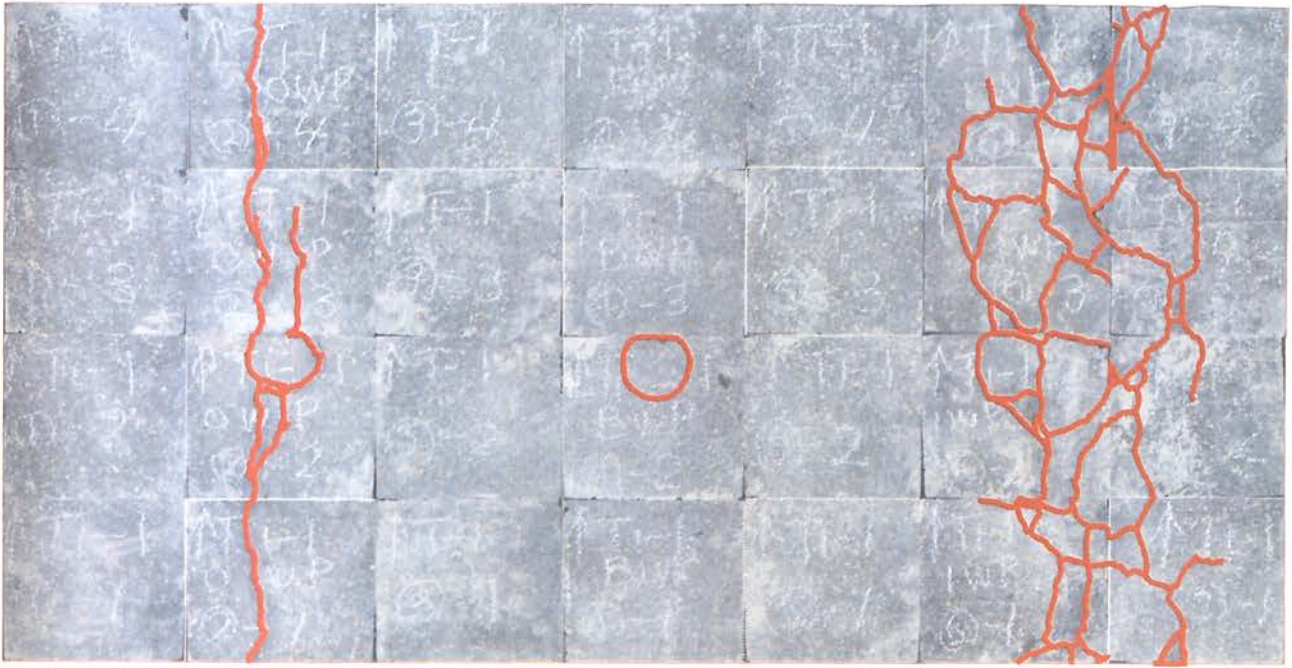
写真-4.7 T1-1 断面のひび割れ（表面側）
