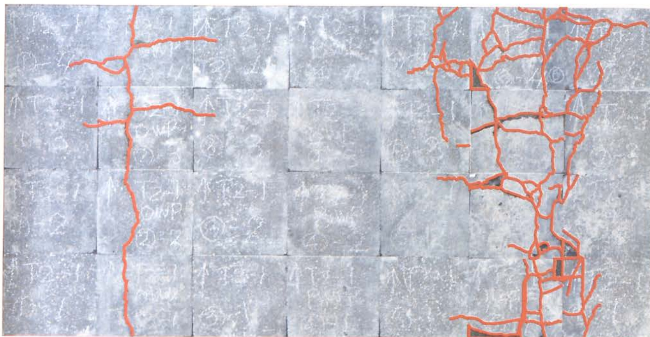
写真-4.11 T2-1 断面のひび割れ（表面側）
