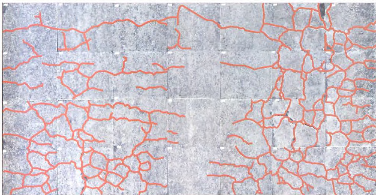
写真-4.6 A断面のひび割れ（底面側）
