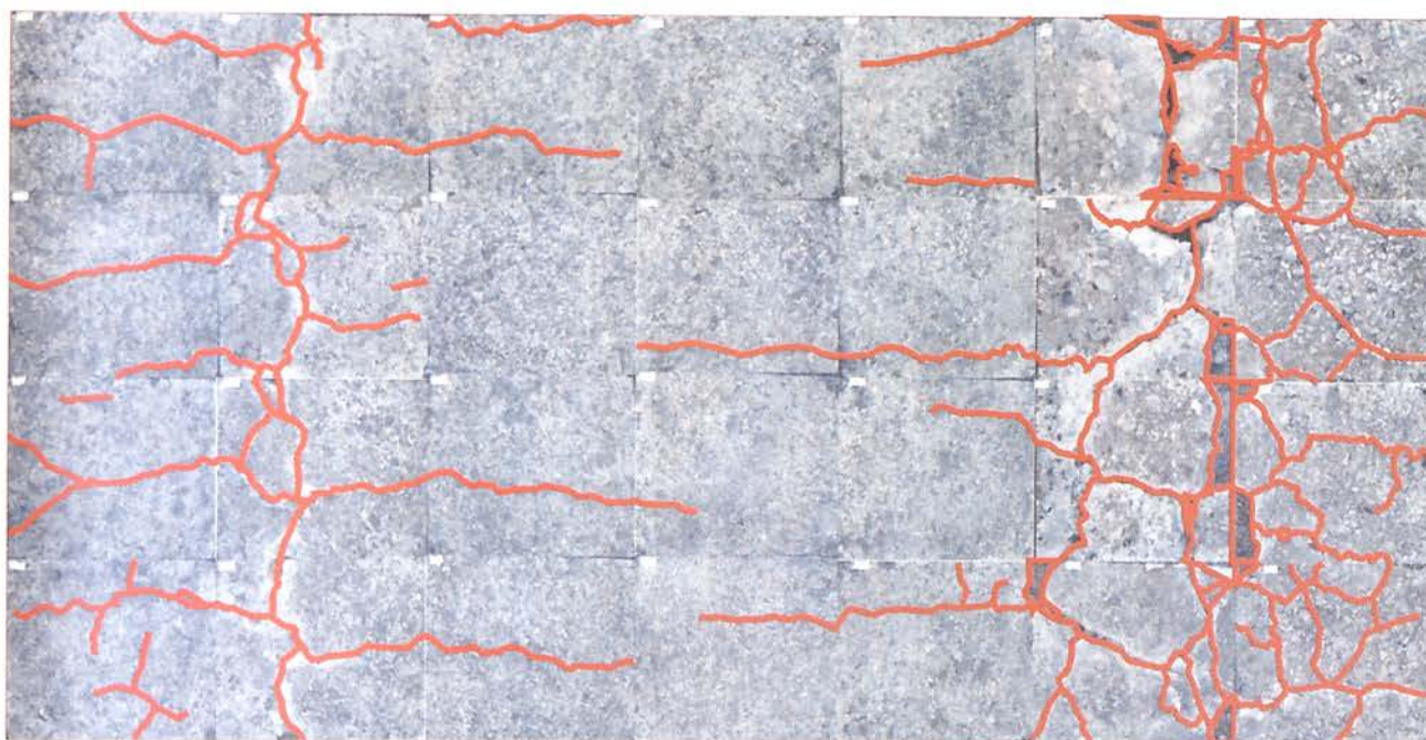
写真-4.12 T2-1 断面のひび割れ（底面側）
