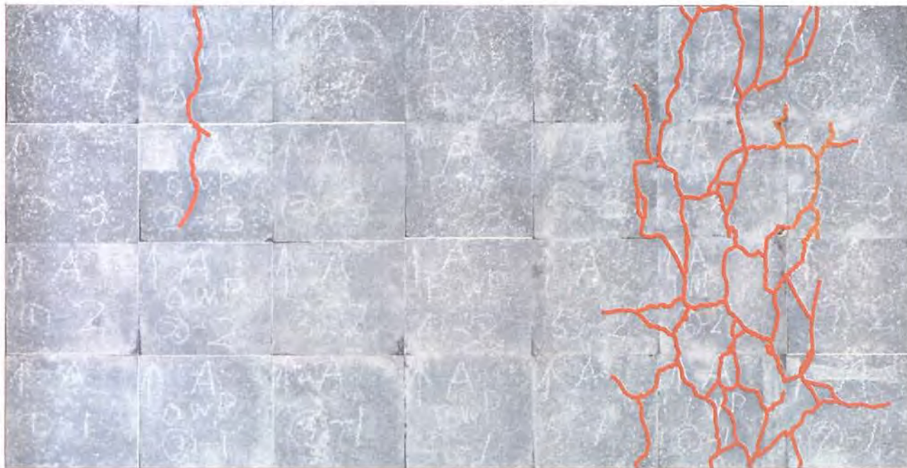
写真-4.5 A断面のひび割れ（表面側）
