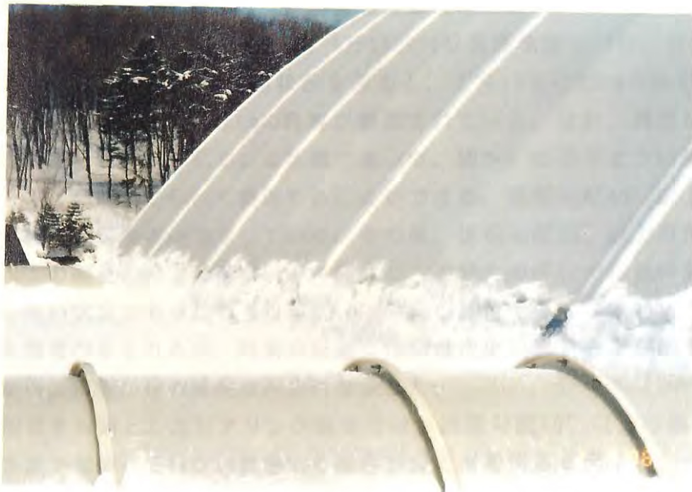
写真2-3 滑雪した屋根雪が膜裾部に溜まった状況
