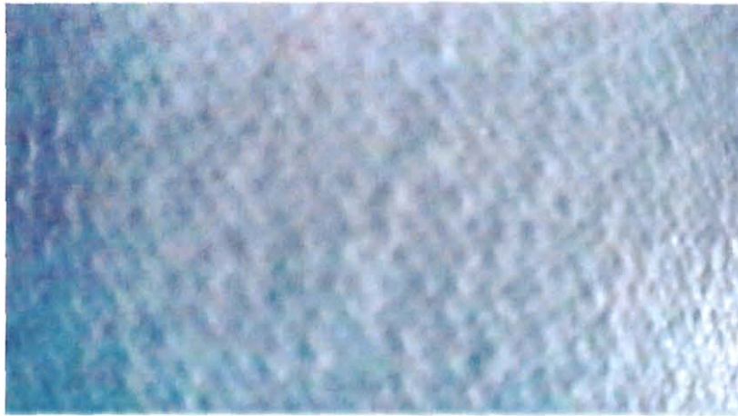
写真 3 - 6 青森市屋内グラウンドサンドームの膜材料表面
